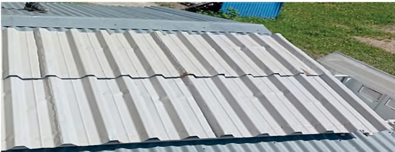
Рисунок 2 – Солнечный коллектор на крыше коровника
