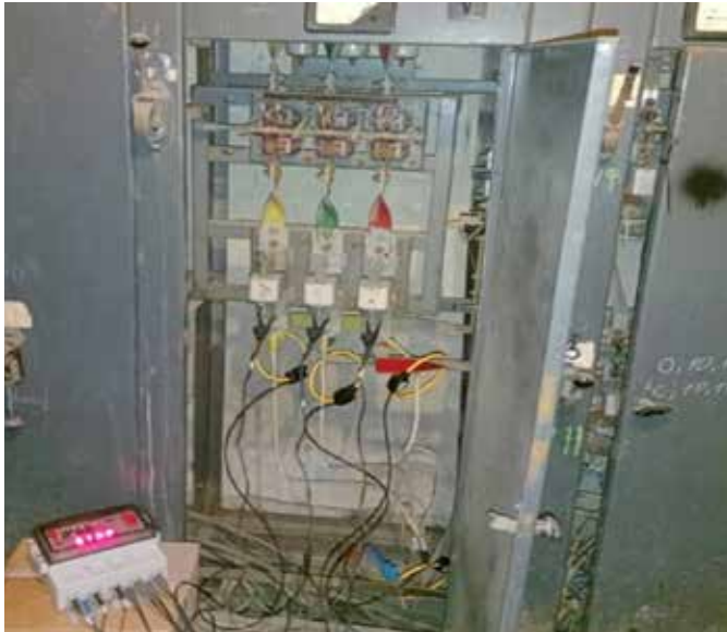
Рисунок 7 – Подключение Sonel PQM-701 к исследуемой электрической сети
