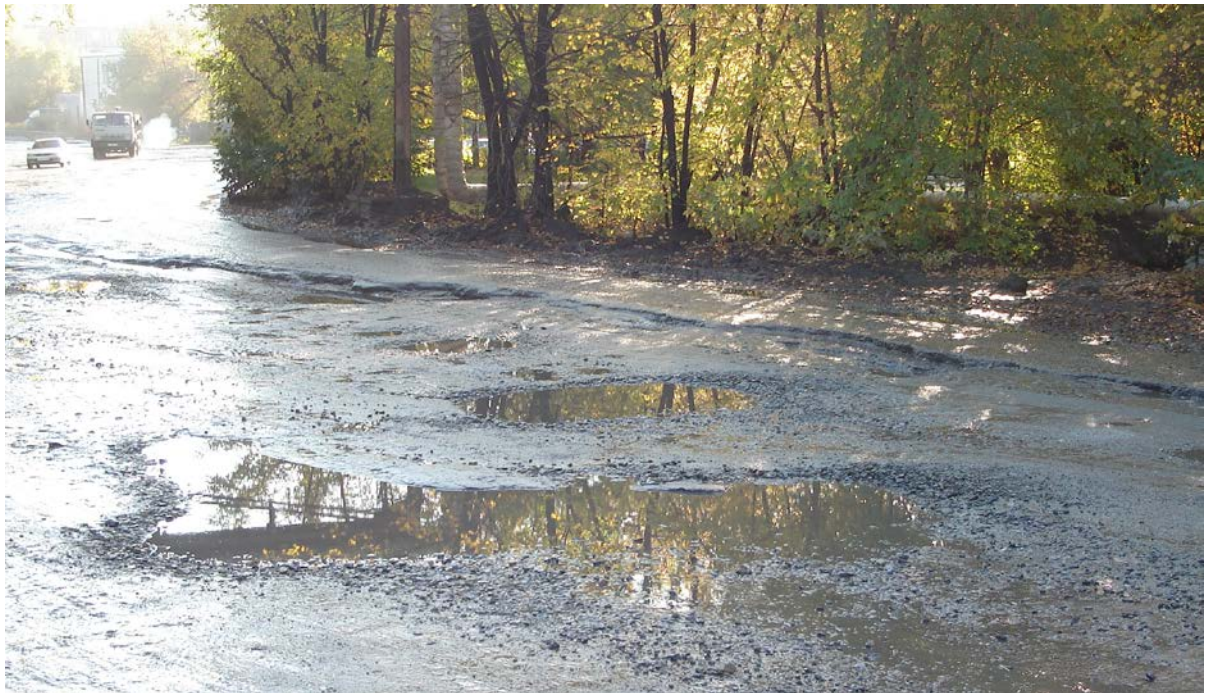
Рисунок 1.7 – Разрушенное дорожное покрытие на улице в г. Кургане (дорожное покрытие не восстановлено после ремонтных работ)
