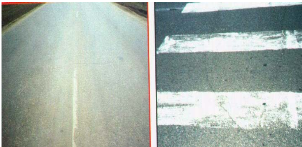
Рисунок 1.6.1 – Износ дорожной разметки (необходимо повторное нанесение разметки, данный вид работ входит в содержание дороги)
