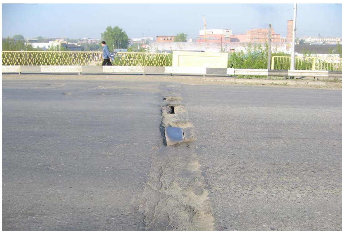
Рисунок 3.1 – Путепровод по ул. Бурова-Петрова, разрушены деформационные швы (необходим ремонт деформационного шва с последующим восстановлением асфальтобетонного покрытия)
