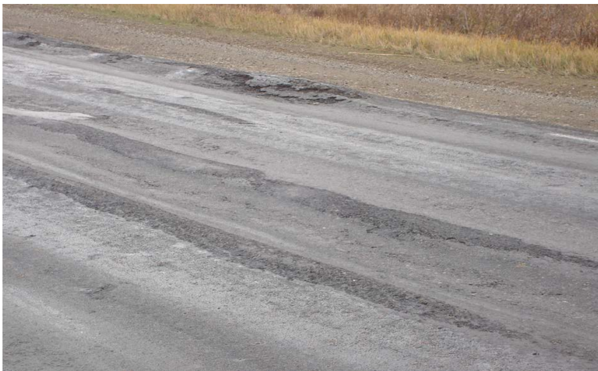
Рисунок 1.2.2 – Автомобильная дорога «Байкал», колея, волна, вызванные потерей несущей способности основания дороги. Глубина колеи до 15 см. Нормативный допуск равен 0,7 см (необходима досыпка и укрепление обочин, при недостатке грунта для восстановления геометрических параметров обочины работа выполняется по отдельной смете и не входит в содержание дороги)
