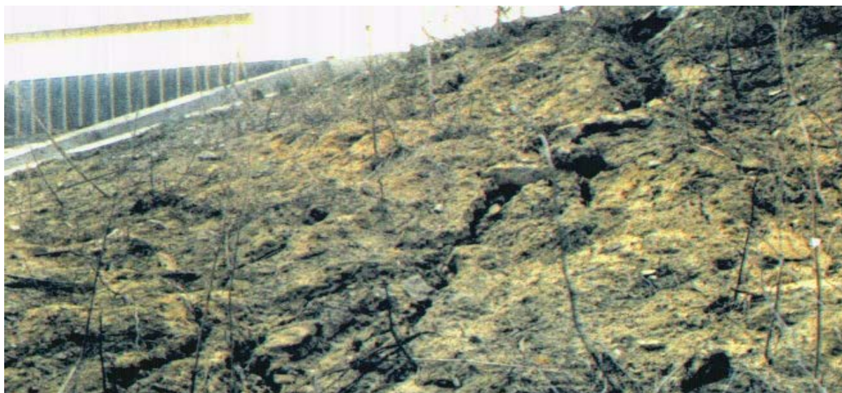
Рисунок 3.3 – Разрушение откосов регулиционных сооружений (необходимы планировка и укрепление конусов)
