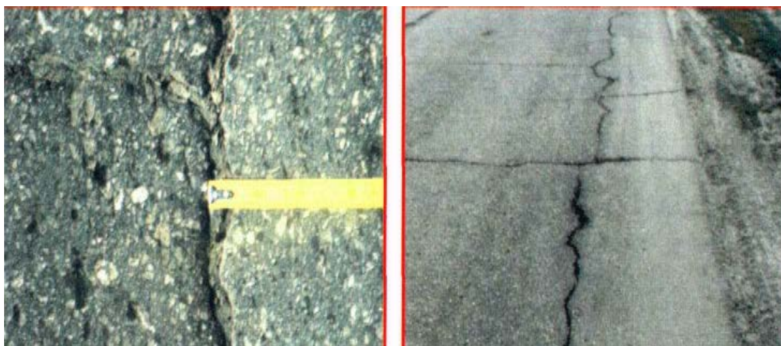
Рисунок 1.1 – Трещины (сплошная сетка трещин может быть устранена только с помощью ремонта верхнего слоя покрытия в целом)
