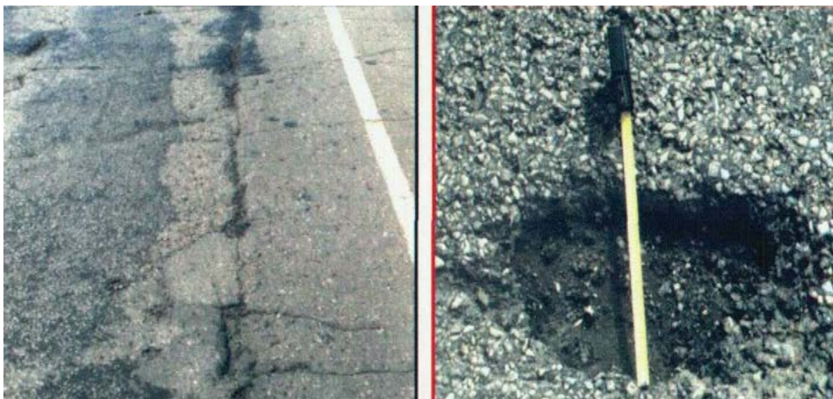
Рисунок 1.3 – Ямы, выбоины (устраняются проведением ямочного ремонта, данный вид работ входит в содержание дороги)
