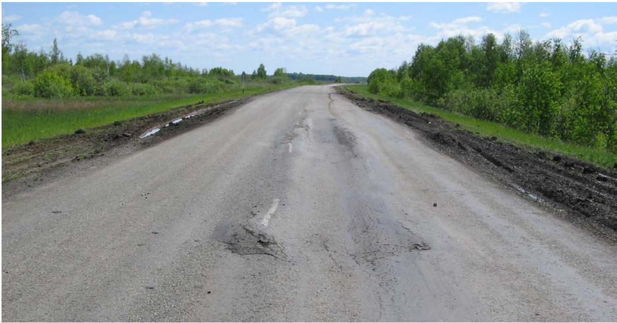
Рисунок 1.2.1 – Автомобильная дорога «Иртыш», пучинистые явления (пучины) вызванные потерей несущей способности основания дороги (необходим капитальный ремонт, работа выполняется по отдельной смете и не входит в содержание дороги)
