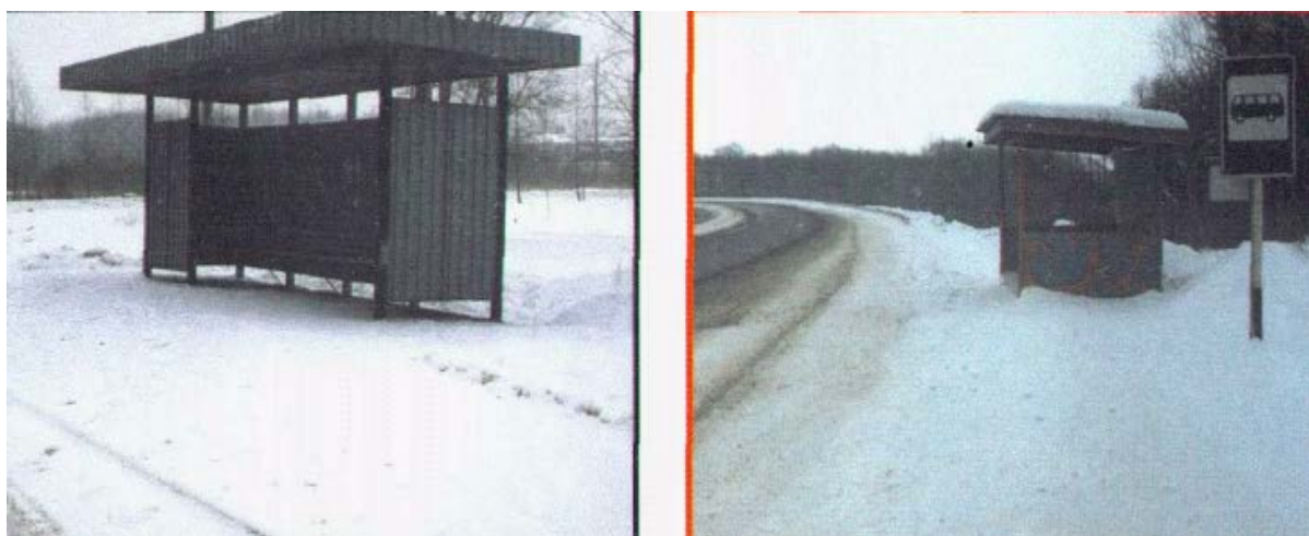
Рисунок 2.5 – Недостатки в зимнем содержании элементов обустройства автодорог (необходимо очищать от снега посадочные площадки, павильоны и остановочные площадки для автобусов)
