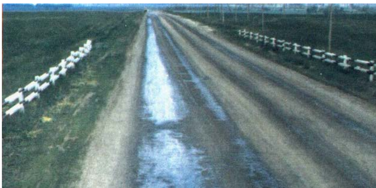
Рисунок 1.4 – Выпотевание битума (устраняется посыпкой песком, песко-щебеночной смесью с дальнейшим уплотнением катком, данный вид работ входит в содержание дороги)
